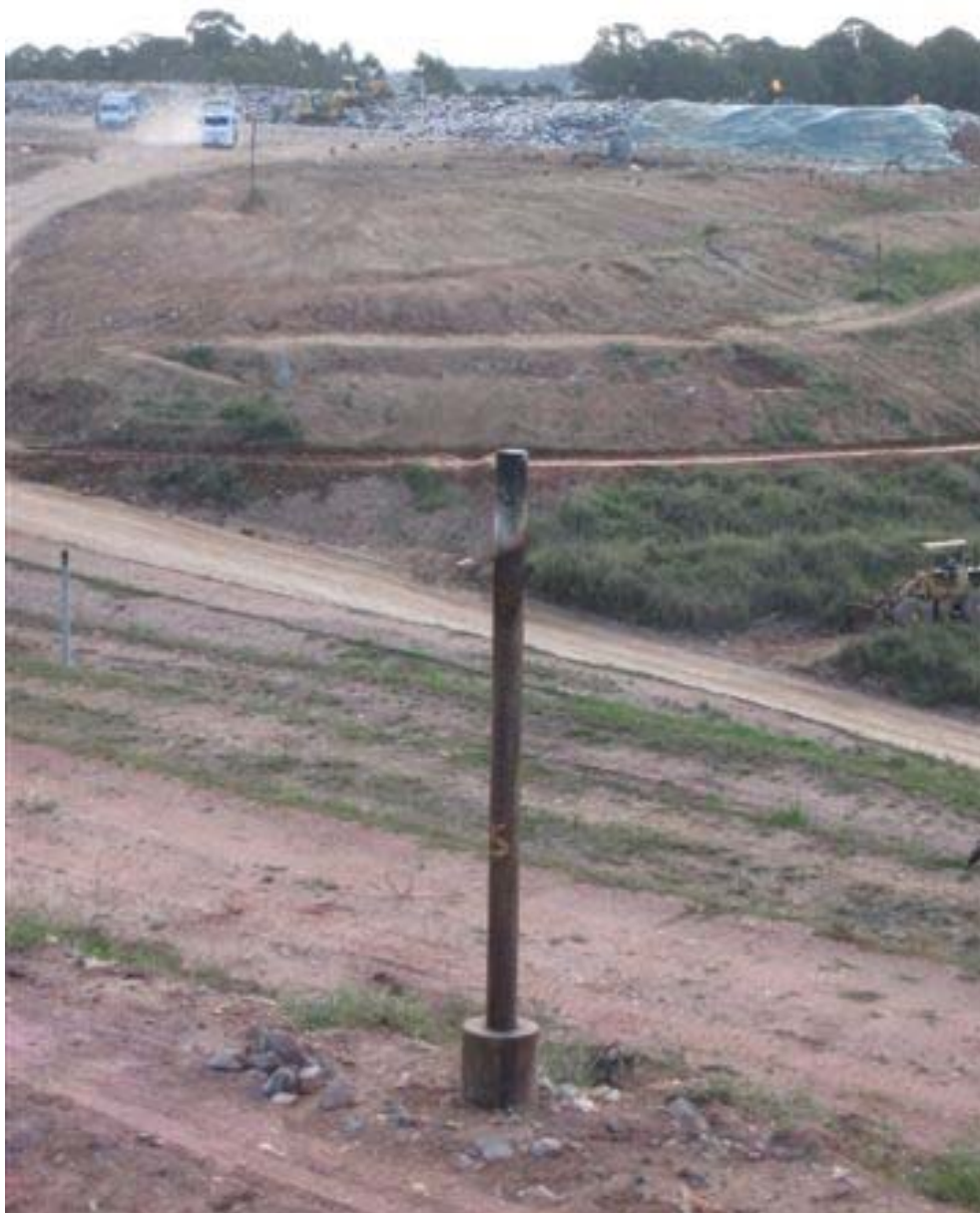
FIGURA 54 – Detalhe de uma das torres de queima e exaustão de gases do Maciço 1, do Aterro Sanitário Caximba. Ao fundo, pode-se ver o Maciço 2, naquele momento, ainda em fase de "crescimento", mas quase chegando ao fim de sua capacidade de receber mais carga. Fonte: Tânia Bloomfield, em 13/04/10. FONTE – Acervo pessoal de Tânia Bloomfield.
